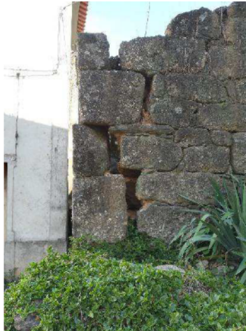
Foto n.º 5 – fissuramento das fachadas (alçado principal / lateral direito)
