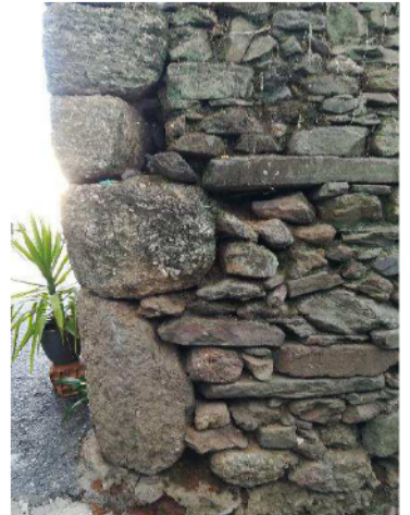
Foto n.º 6 – fissuramento das fachadas (alçado posterior)
