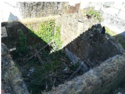
Foto n.º 7 – vista da parte do edifício cuja cobertura colapsou
