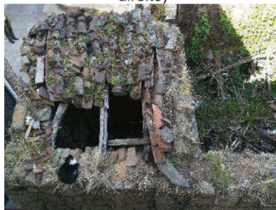
Foto n.º 8 – vista da parte do edifício com cobertura em avançado estado de ruína
